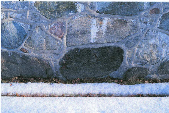
Grønnsteinskonglomerat (brannskadd?) i Vekthusets vestvegg
