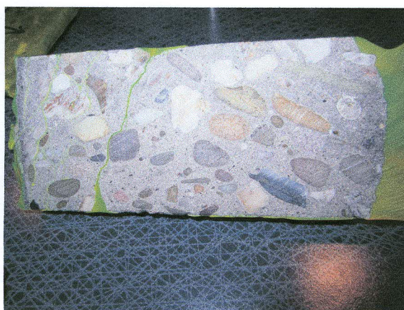
Gjennomskåret borkjerne med hollandsk demningbetong. Epoxyplast avslører sprekkedannelse.
